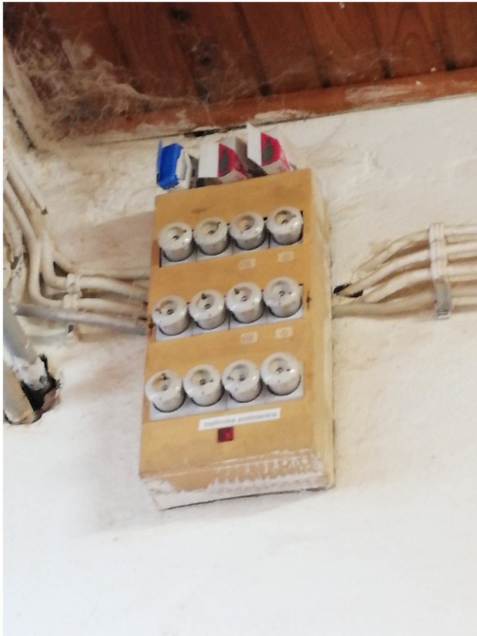
Slika 5.1. Razvodni ormar (fotografirano 3.6.2019.).
