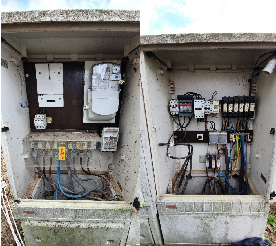
Slika 2.6. OMM izvan trafostanice, mjerni (lijevo) i upravljački (desno) dio javne rasvjete u Ulici Matije Gupca u Posavskim Podgajcima (16.3.2020.)
