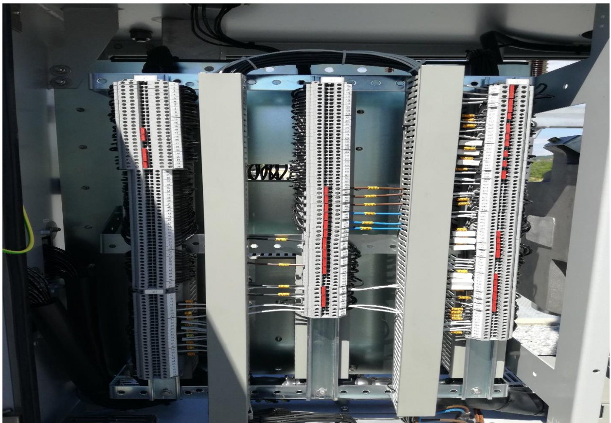
Slika 5.13. Redne stezaljke u ormaru prekidača
