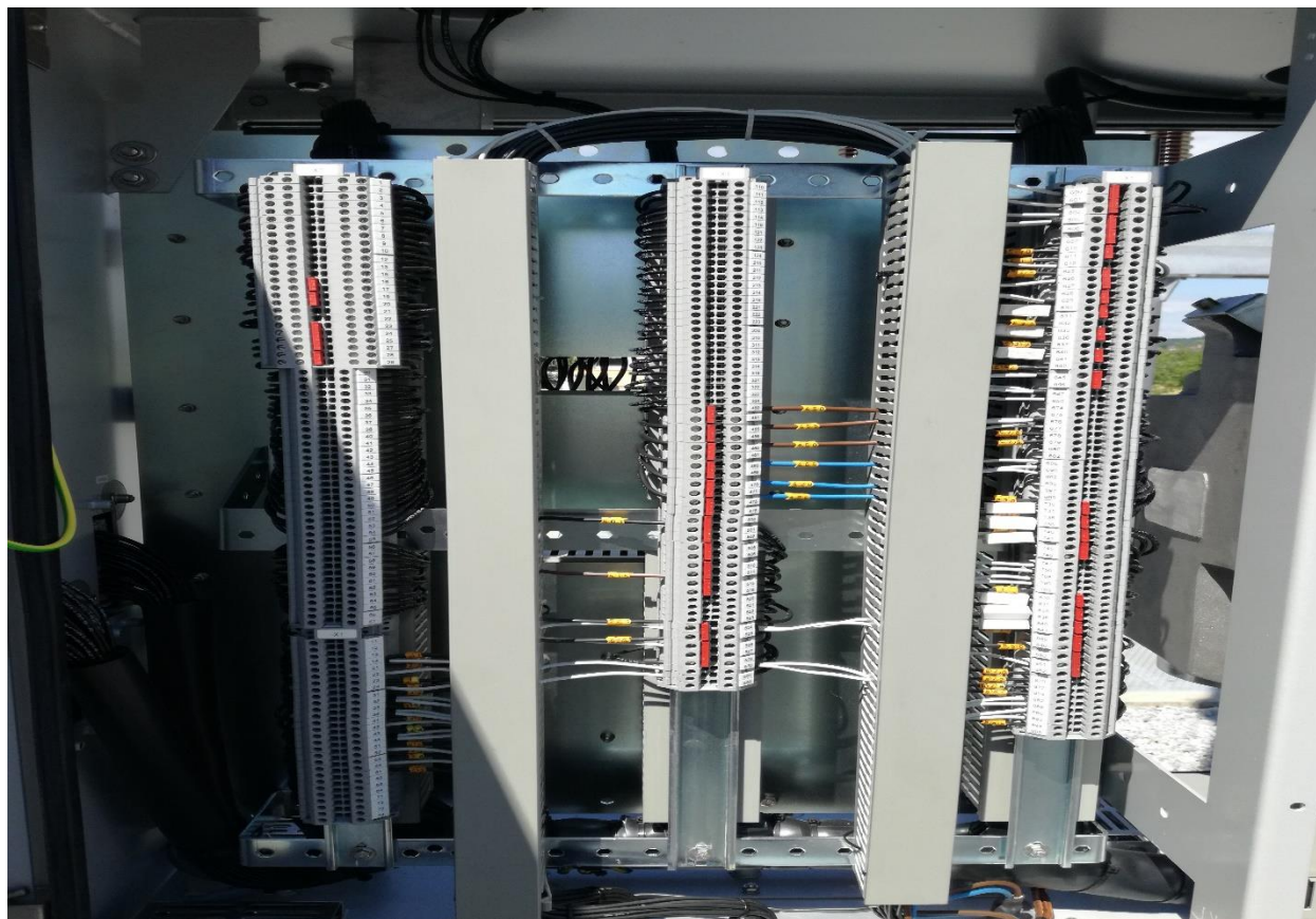
Slika 5.13. Redne stezaljke u ormaru prekidača
