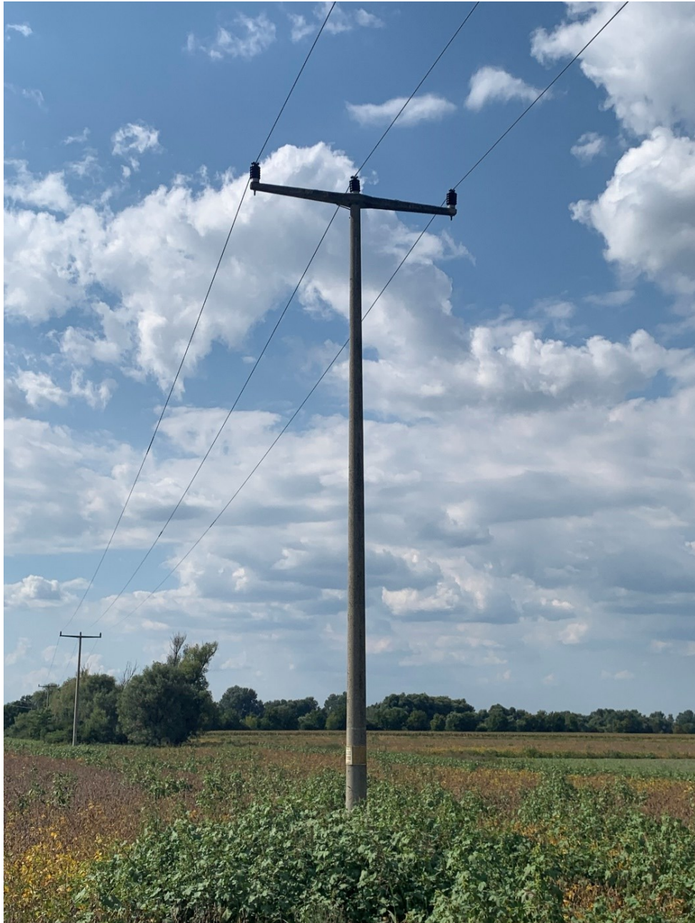
Slika 4.1. Prikaz 10 kV dalekovoda
