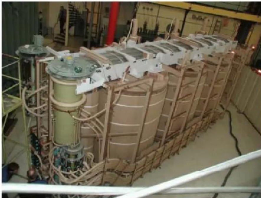
Slika 3.6. Trofazni autotransformator 400MVA, 400/231/10,5 kV [10].
