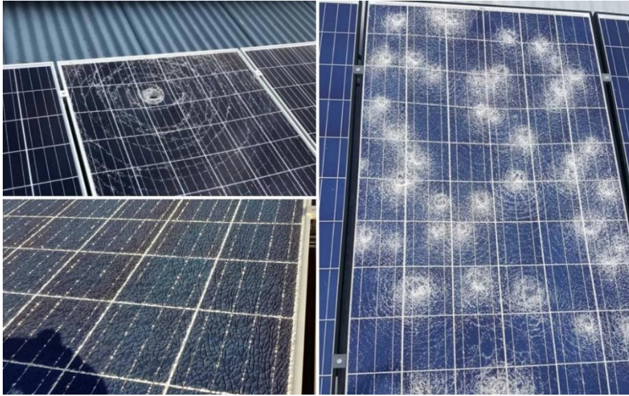
Sl. 3.10. Puknuće stakla uzrokovano elementarnim nepogodama [29].
