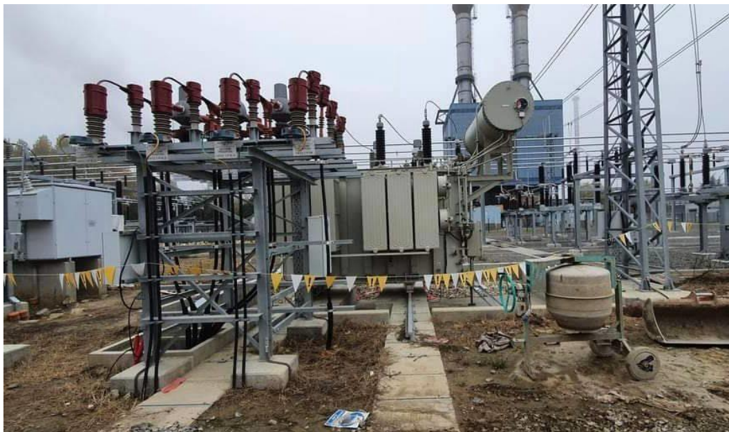
Slika 2.9. Trafo polje 35 kV
