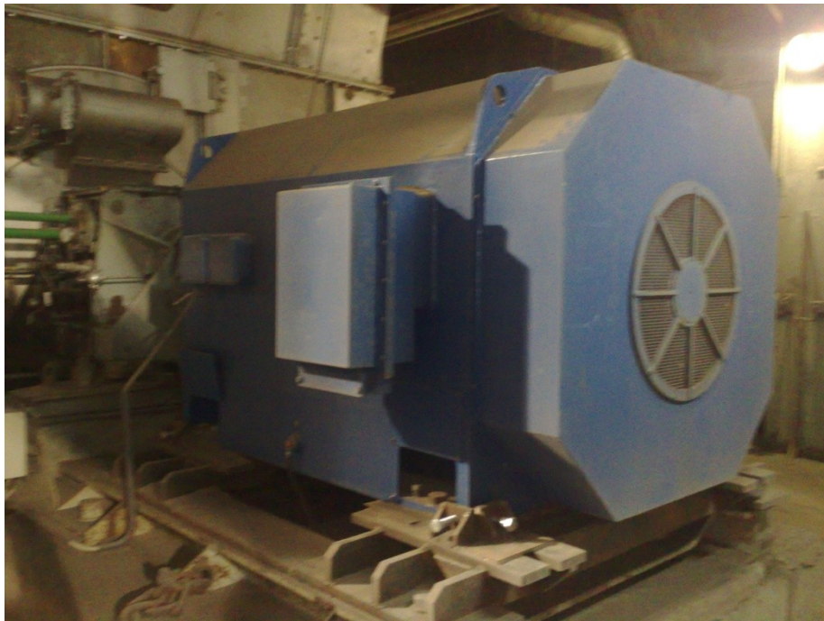
Slika 7.14. Motor mlina 6. snage 800 kW bloka 6. TE Tuzla
