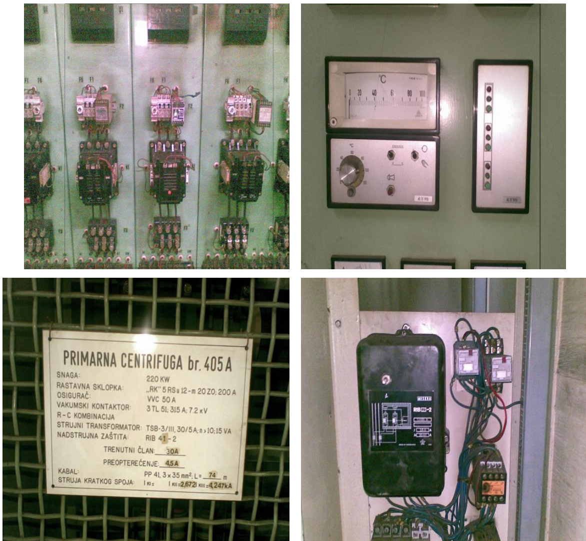
Slika 4.1. Prikaz 6 kV ćelije primarne centrifuge 220 kW i pripadajuće elektromehaničke zaštite kojom se štiti u Rudniku Banovići
