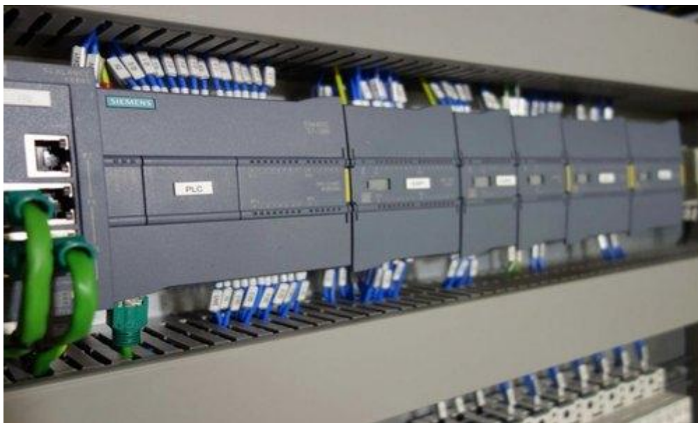
Slika 3.1.: PLC u upravljačkom ormaru
