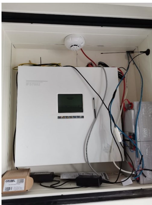
Slika 4.10. Kontrolna jedinica za protupožarni sustav i senzor za vatru
