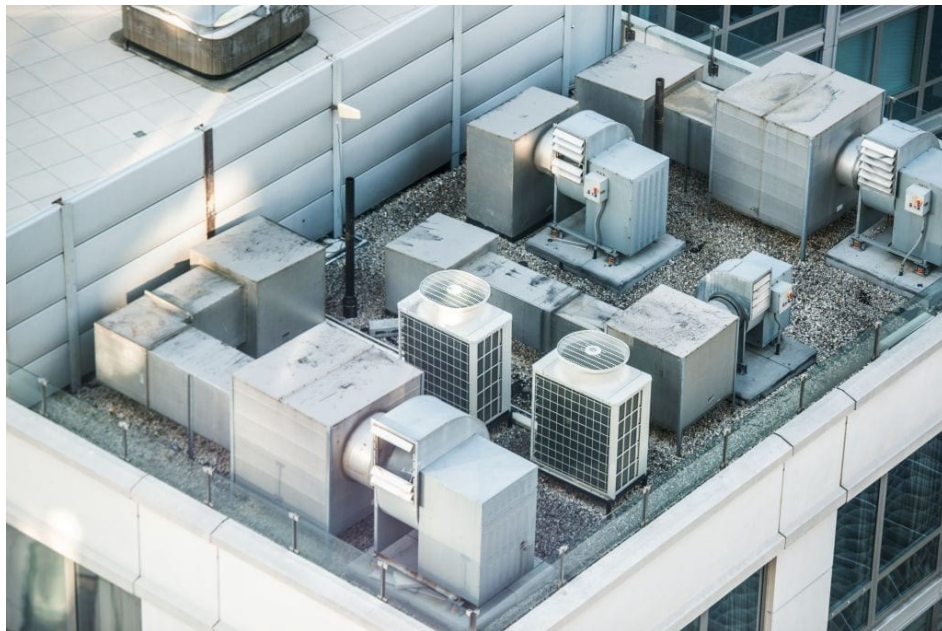
Slika 3.3.3. Prikaz HVAC sustava na krovu zgrade
