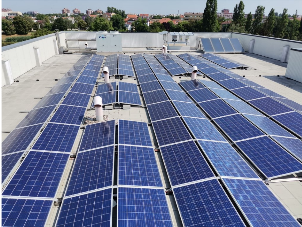
Slika 4.16. Fotonaponska elektrana na krovu zgrade
