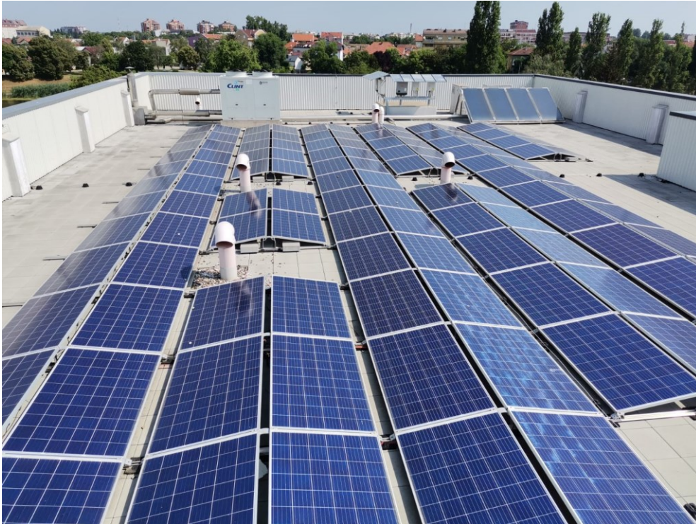
Slika 4.16. Fotonaponska elektrana na krovu zgrade
