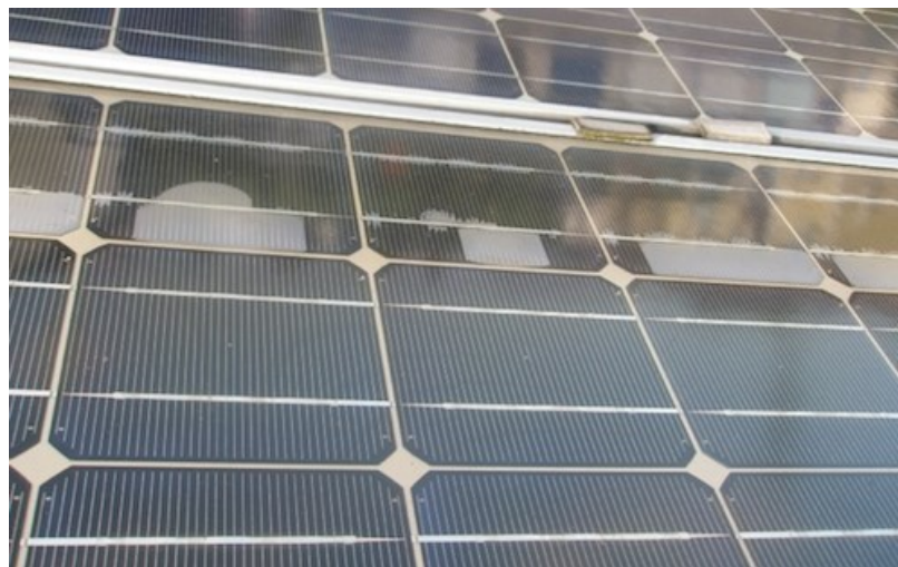
Slika 4.2. Delaminacija c-Si modula [19]
