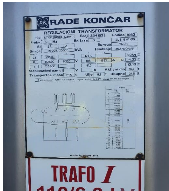
Slika 5.9. Natpisna pločica energetskog transformatora (fotografirano 13. travnja 2022.)
