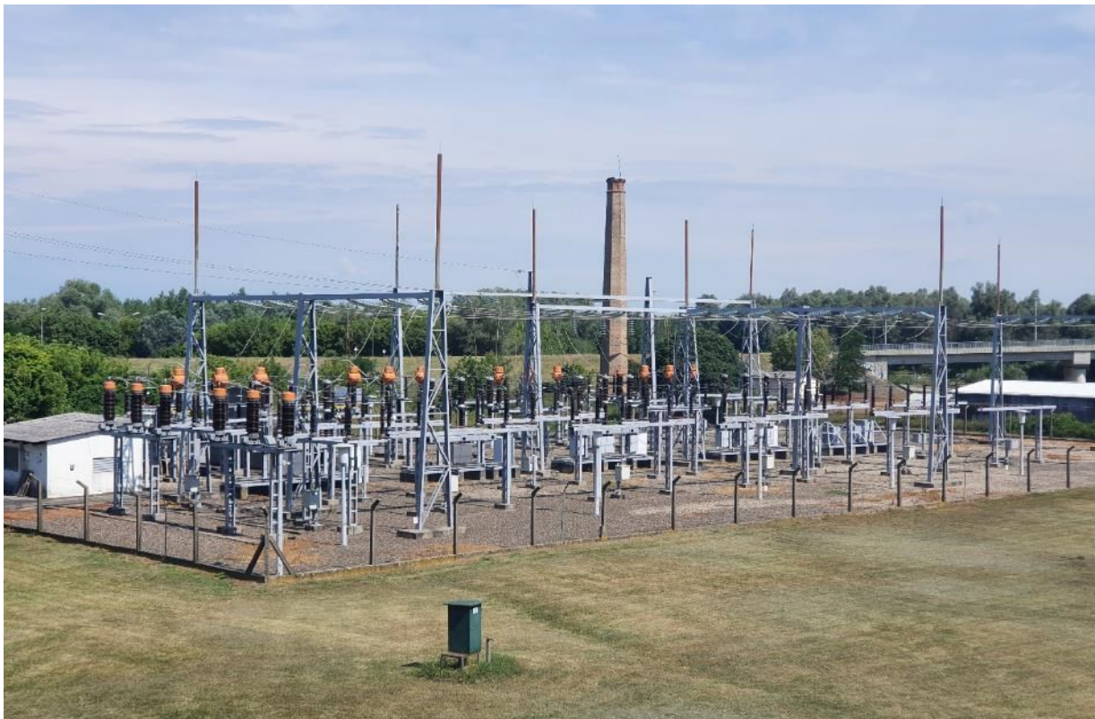
Slika 5.1. Transformatorska stanica TS 110/6,3 kV (fotografirano 7. srpnja 2022)
