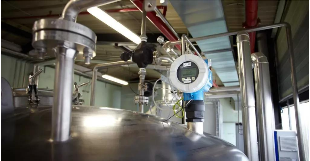
Slika 7.3. Prosonic FMU44 montiran u postrojenju
