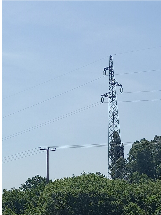
Slika 2.3. Prikaz 10 kV dalekovoda (lijevo) i 35 kV dalekovoda (desno)
