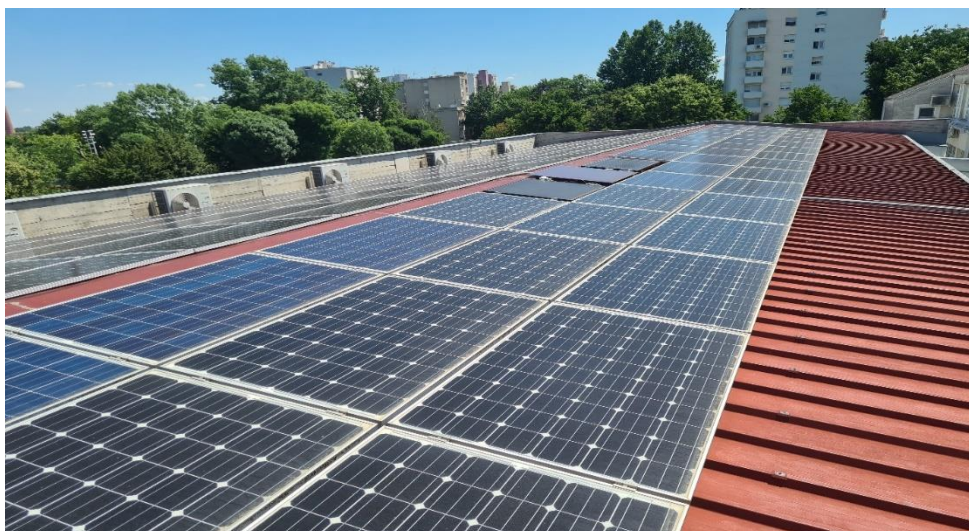
Slika 3.3 Prikaz fotonaponskih panela [14]
