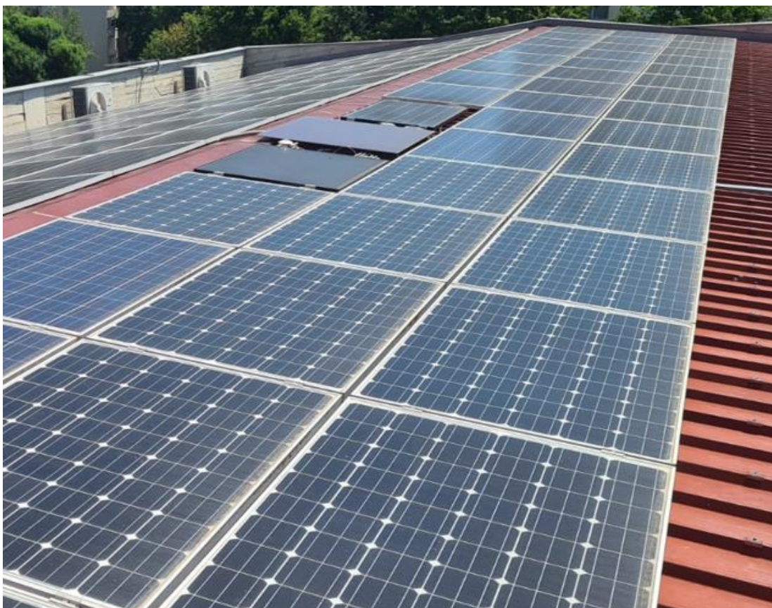
Slika 3.3 Prikaz fotonaponskih panela
