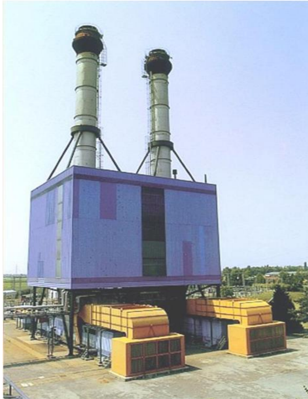
Slika 2.2. Plinsko turbinska elektrana [1]
