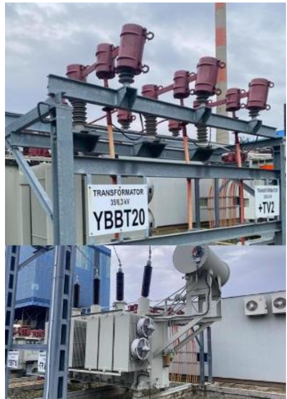
Slika 3.19. Prikaz transformatora 35/6,3 kV (fotografirano 10.siječnja 2023.)
