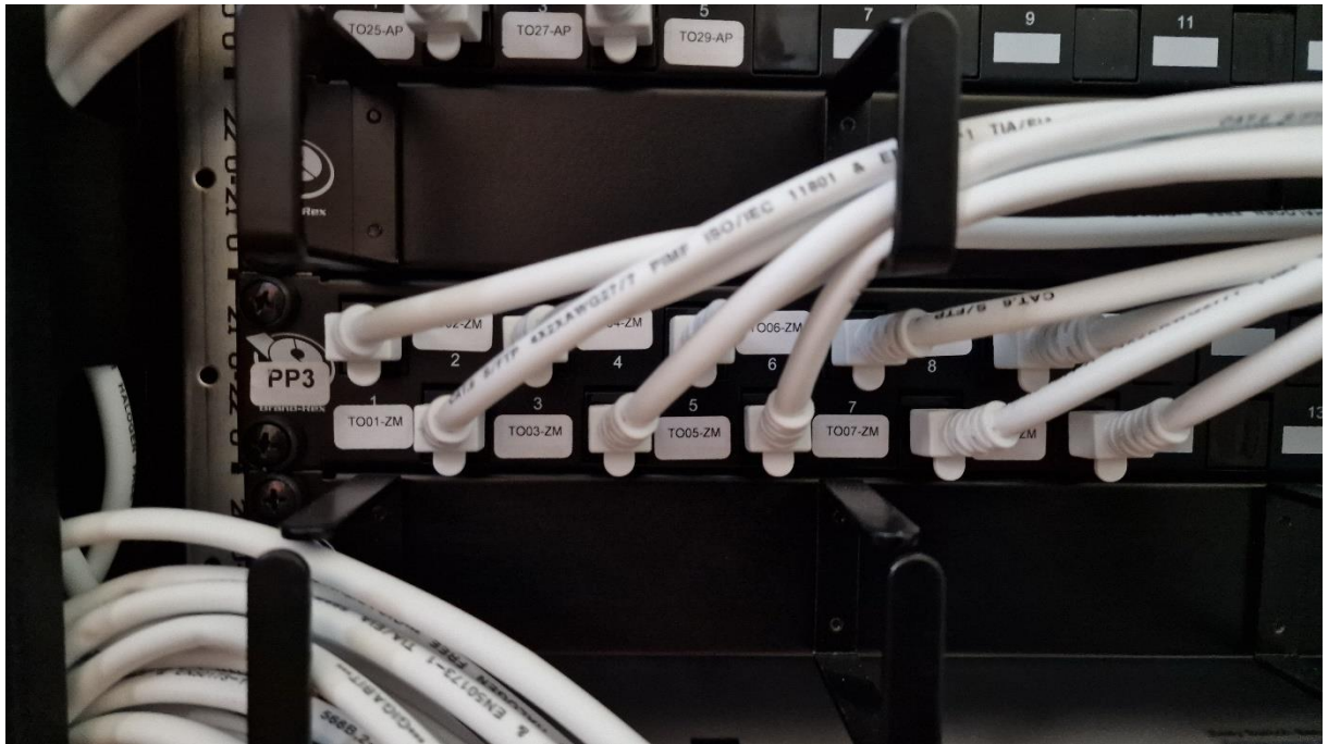
Slika 3.1 Primjer označavanja utičnica na prespojnom panelu
