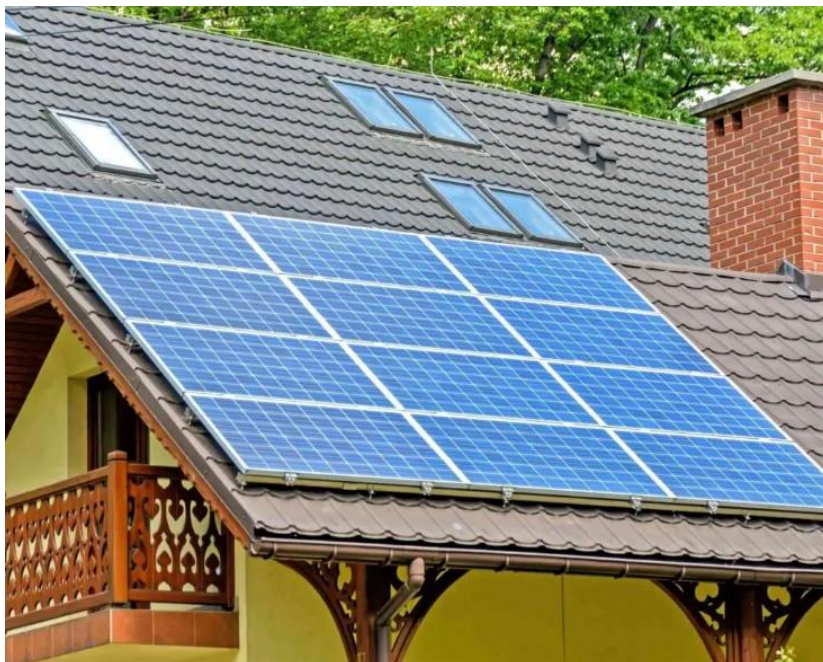
Sl.3.2. Primjer djelomično integrirane sunčane elektrane na krovu obiteljske kuće[13]
