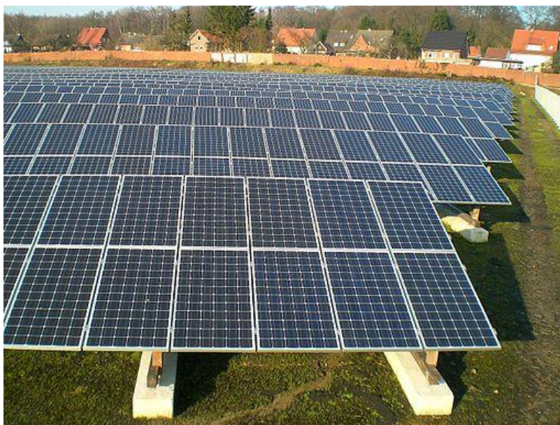
Slika 3.1. Prikaz fotonaponske elektrane s fiksnim položajem [10]
