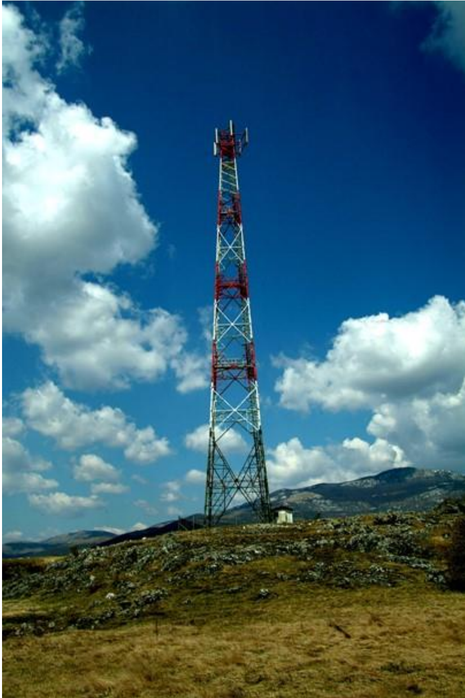
Slika 3.3. Rešetkasti antenski stup [9]
