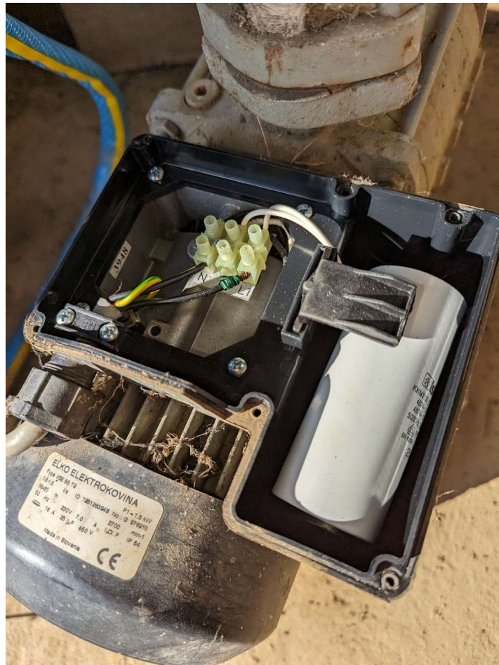
Slika 5.3. Naponske priključnice motora i radni kondenzator
