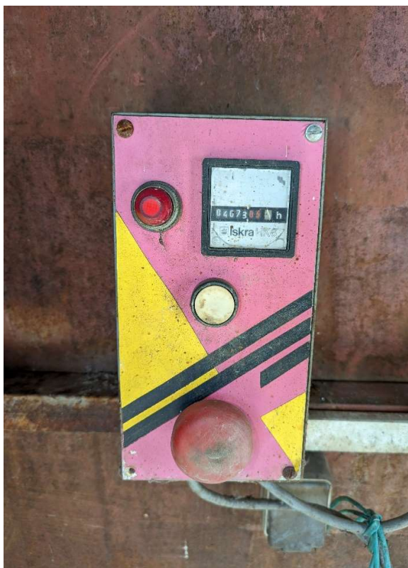
Slika 5.5: Mjerni i regulacijski ormar
