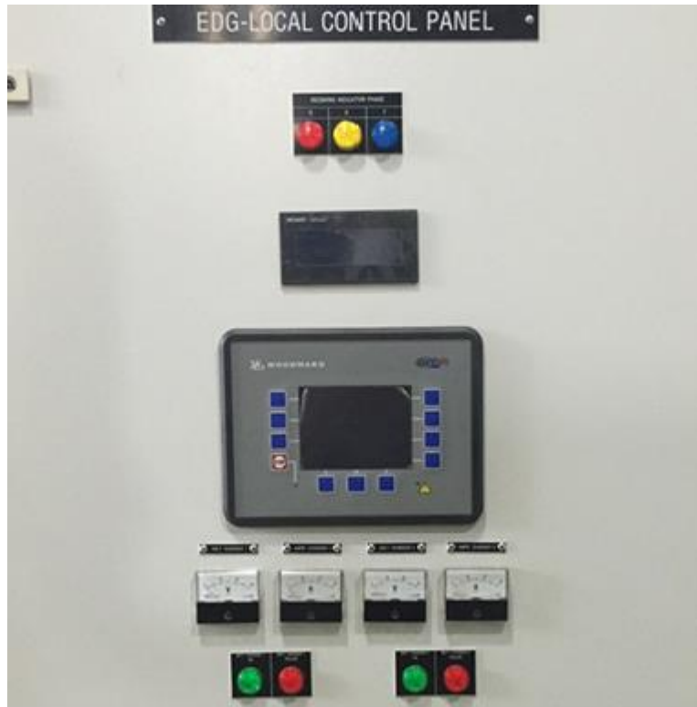
Sl. 4.2. Primjer sučelja čovjek-stroj u lokalnim kontrolnim sustavima [28]
