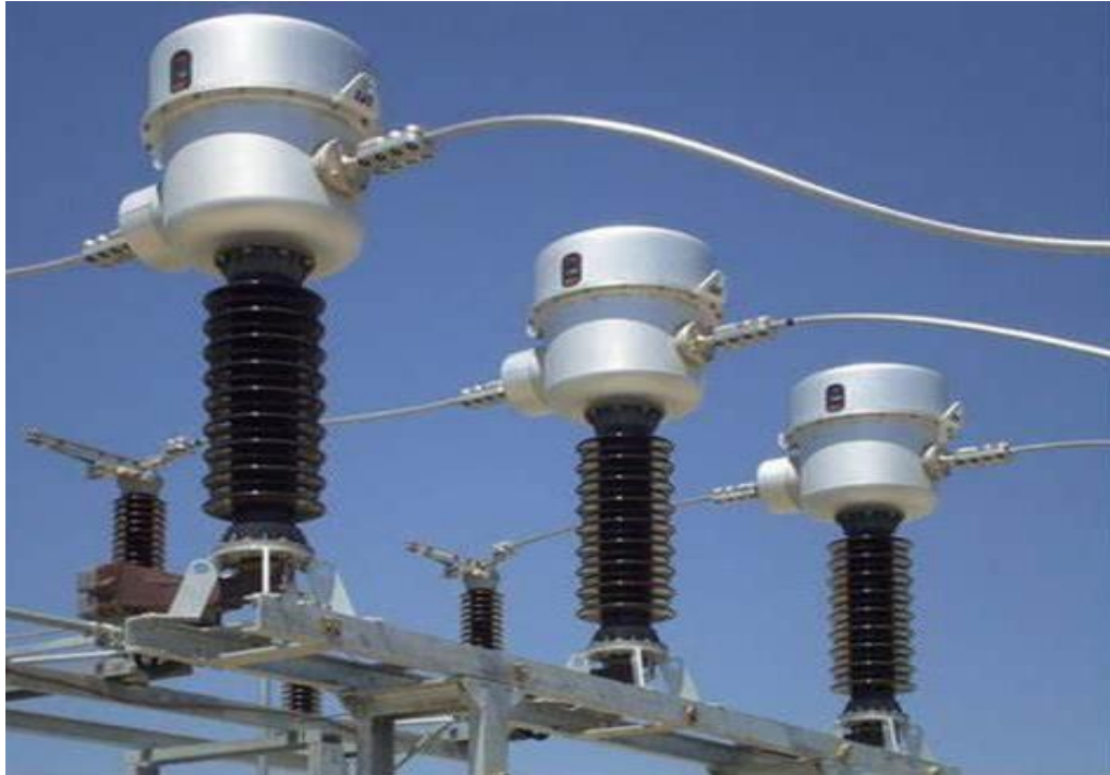
Slika 3.4. Strujni mjerni transformator montiran na potpornom izolatoru [6]
