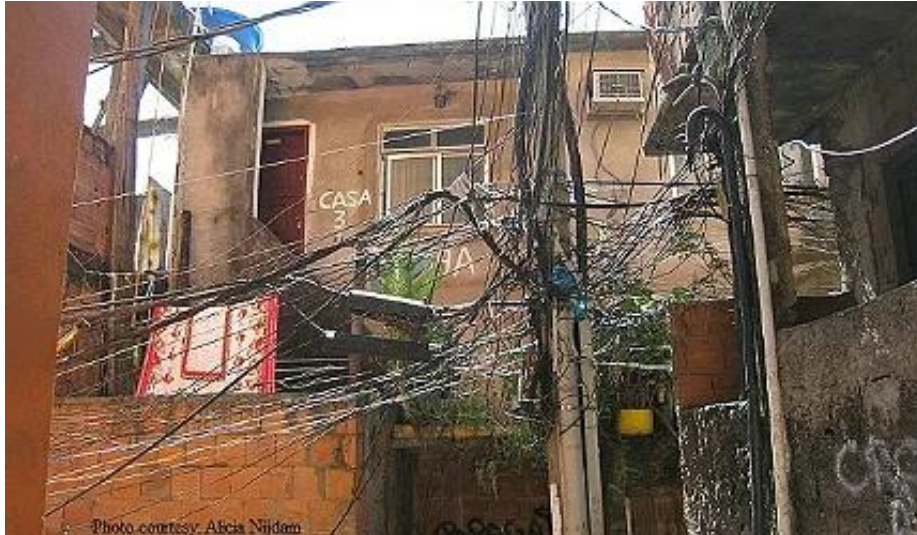
Slika 5.6. Primjer ilegalnih priključaka na distribucijskom sustavu u Brazilu [21]
