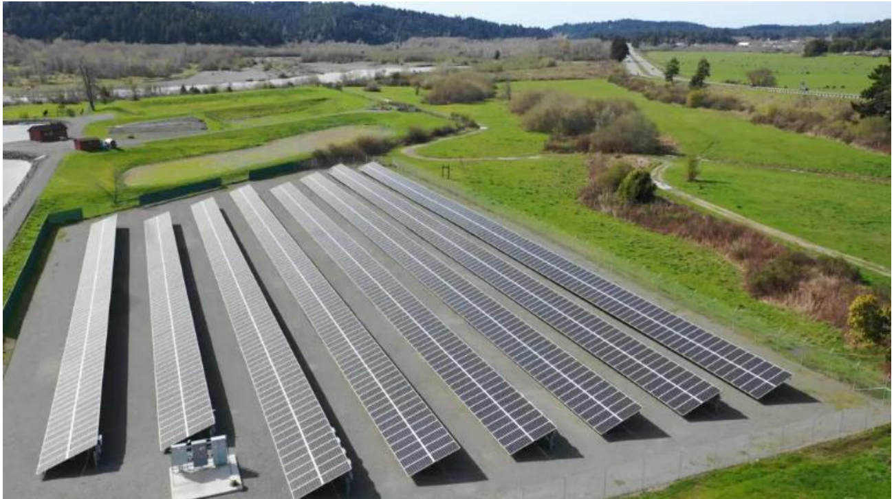
Slika 3.2. Mini solarna elektrana [2]
