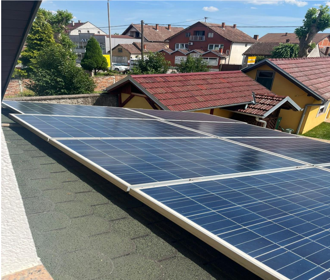
Slika 3.3. Polikristalni fotonaponski moduli/fotonaponski niz na krovu kuće (Vinkovci)
