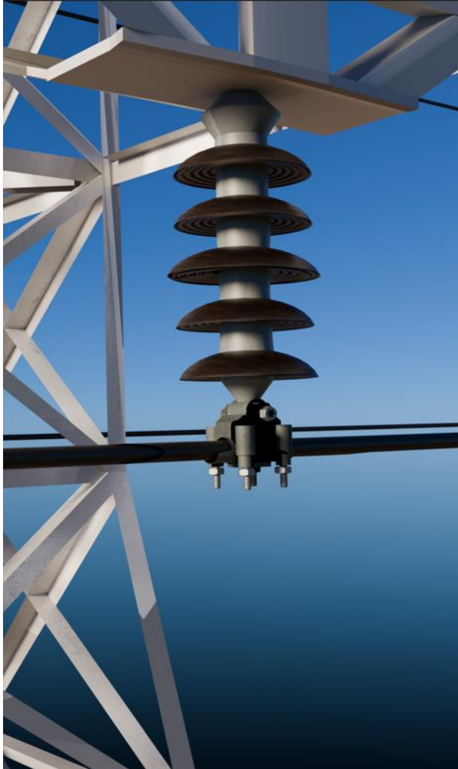
Slika 5.4. Prikaz detalja visećeg izolatora i visokonaponskog kabla
