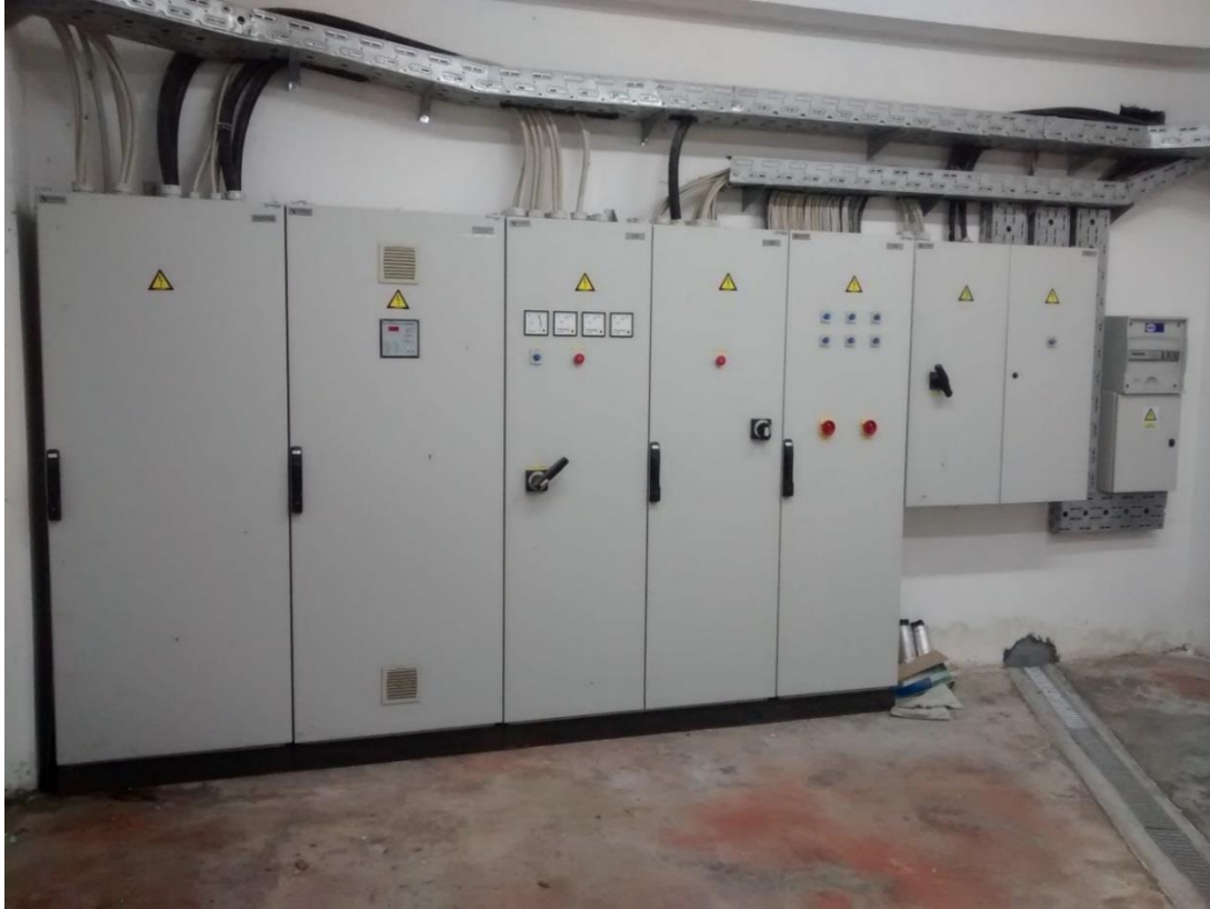
Slika 4.4. Glavni razvodni ormar GR [2]
