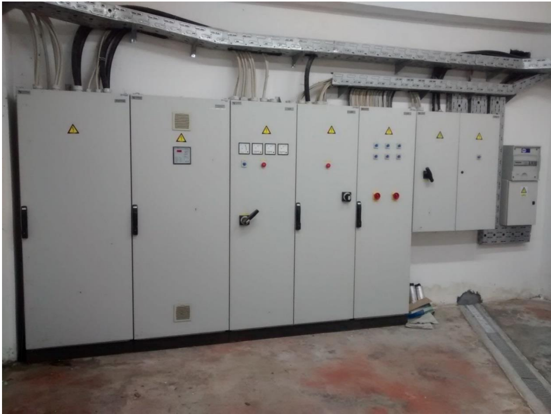
Slika 4.4. Glavni razvodni ormar GR [2]
