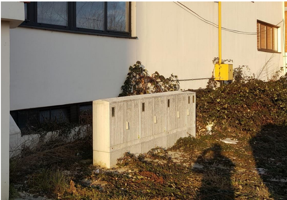
Slika 4.1. Samostojeći mjerni razvodni ormari [2]
