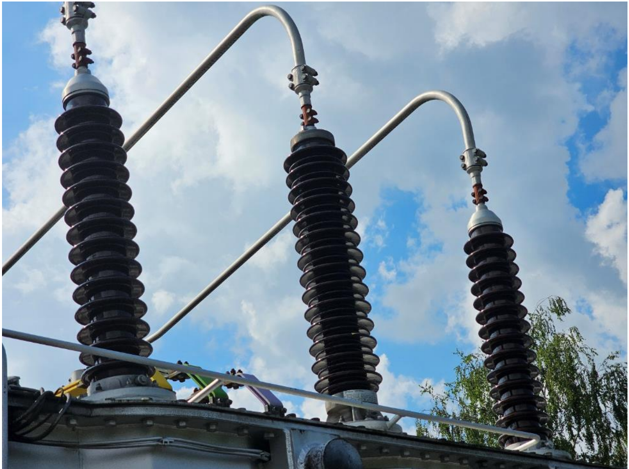
Slika 3.2. Porculanski provodni izolator na transformatoru
