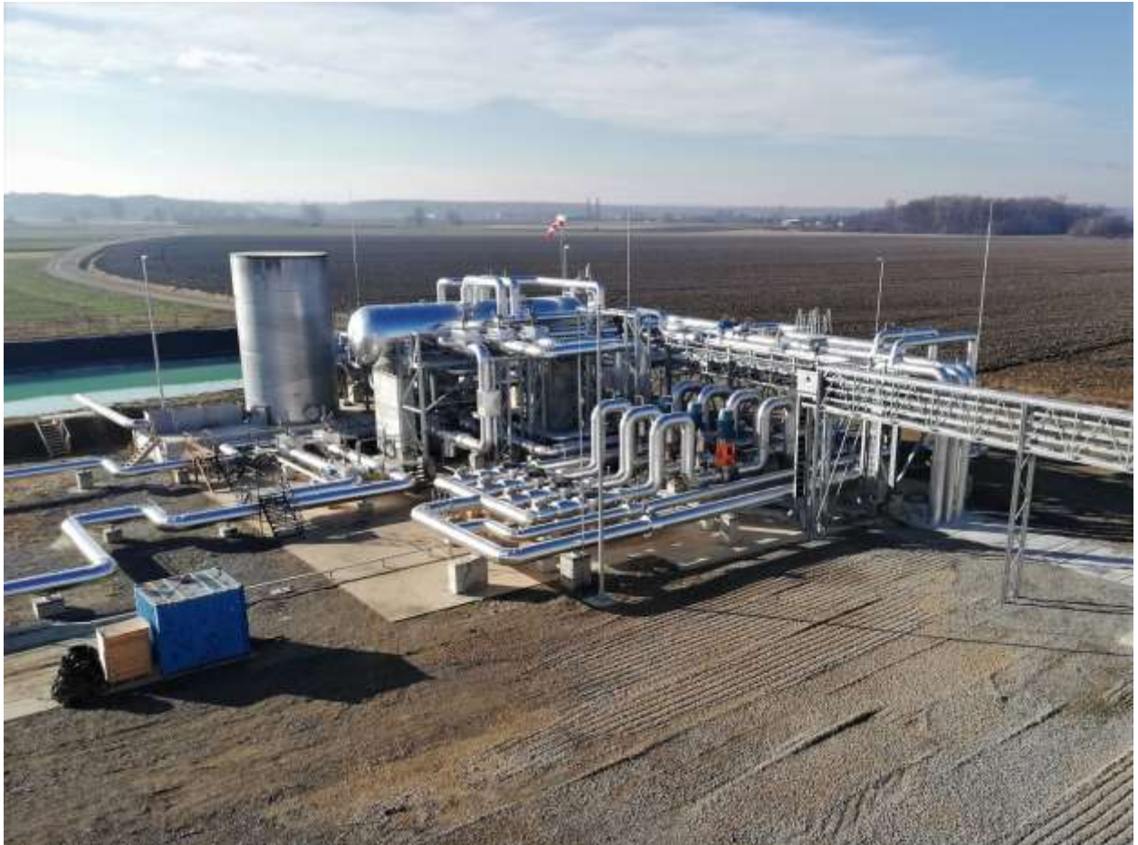
Slika 3.16. Geotermalna elektrana Velika 1 [13]
