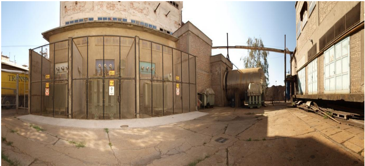
Slika 5.1. Transformatori 35/6,3 kV u Tvornici šećera Osijek
