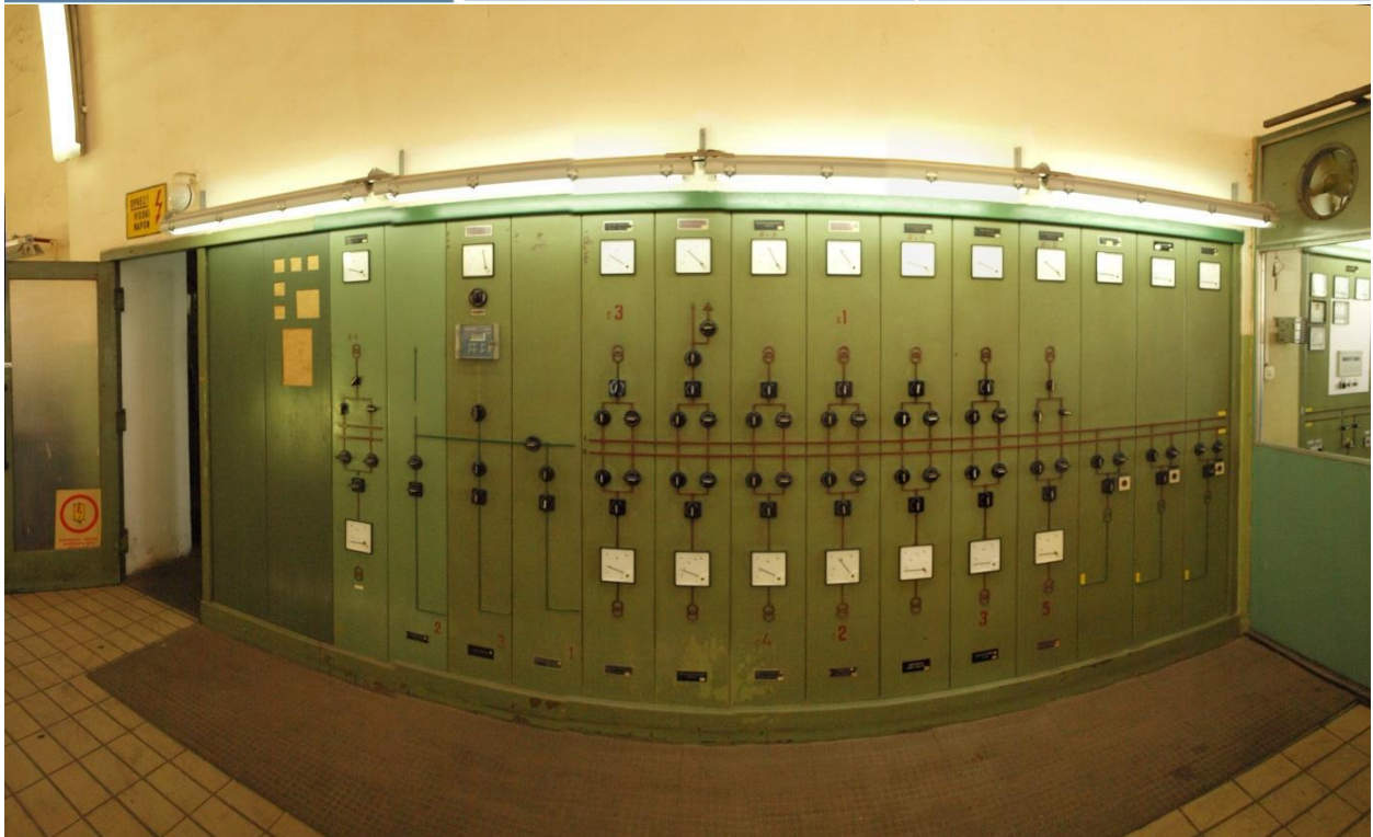
Slika 5.2. Uklopnica u energani (komandna ploča na kojoj su prikazana stanja svih transformatora u pogonu i na kojoj je moguće pratiti i trenutnu potrošnju na istim transformatorima)
