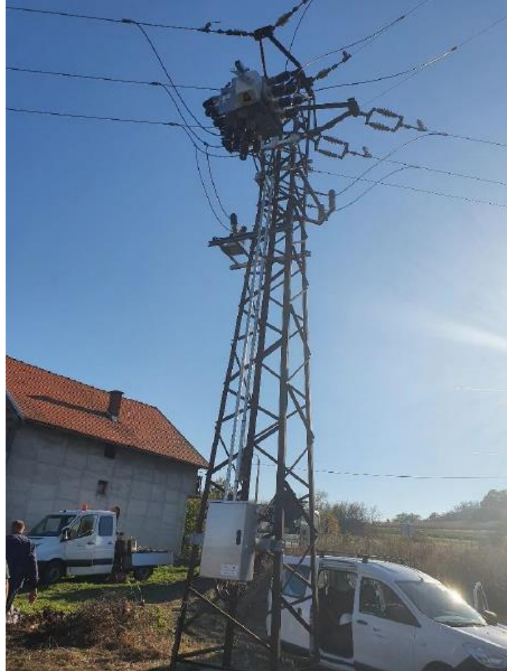
Slika 5-10 Konačan izgled cijelog stupa s DURN-om i upravljačkim ormarom
