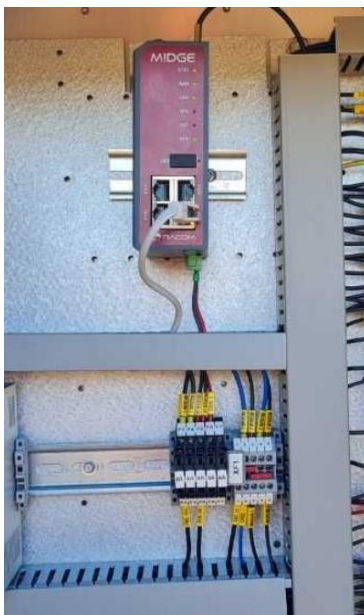
Slika 5-7 Primjer ugradnje GPRS-a u upravljački ormarić
