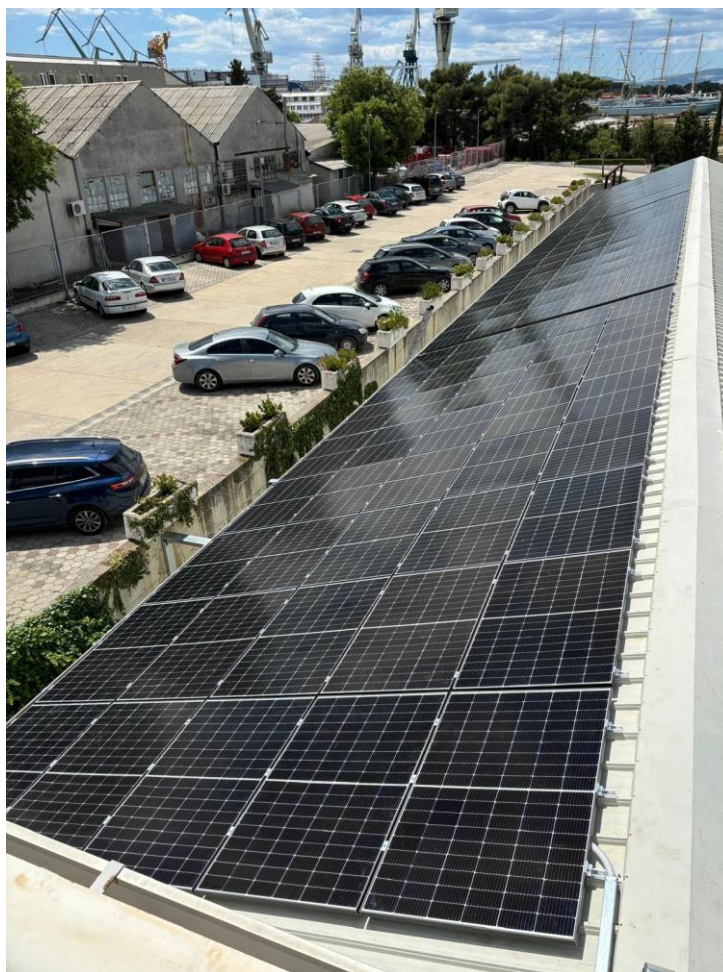
Slika 4.2 Prikaz instaliranih fotonaponskih modula
