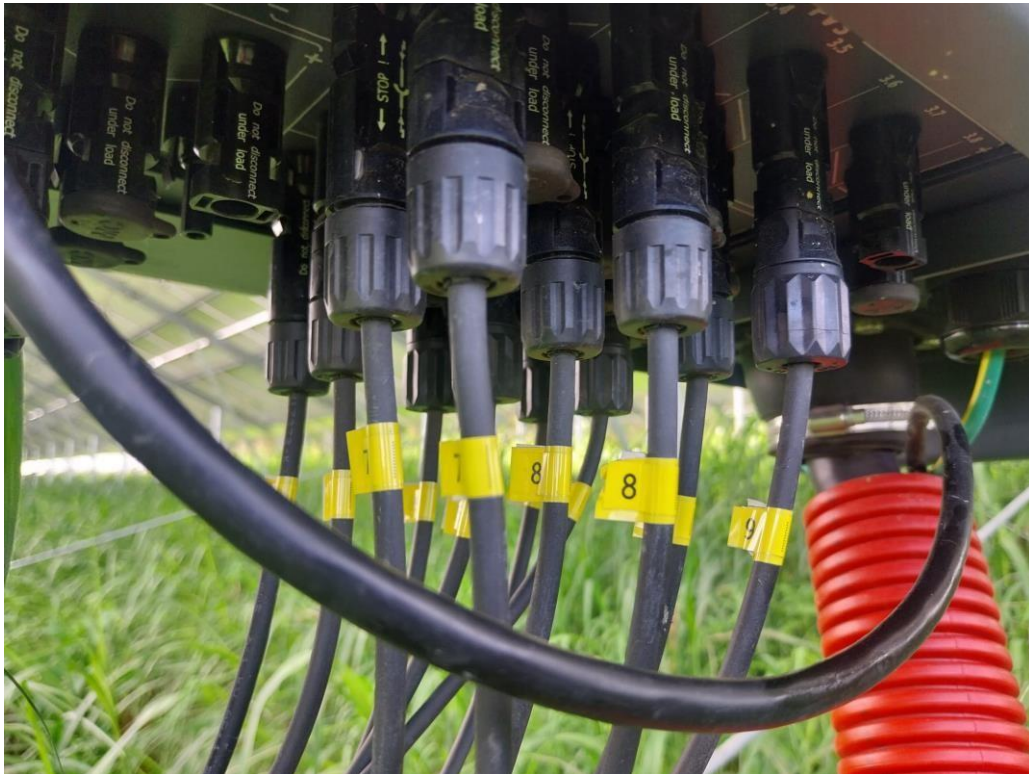
Slika 5.3 Prikaz električnih spojeva na inverteru
