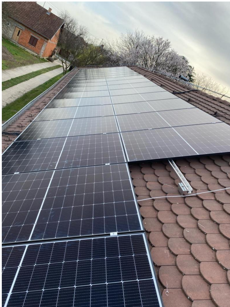
Slika 3.5 Prikaz postavljenih fotonaponskih modula na krov
