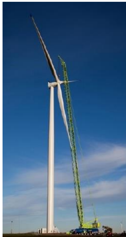
Sl.4.1. Vjetroagregat SWT 3.0- 101.
