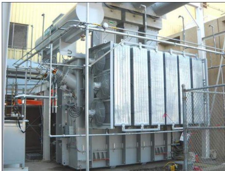
Slika 3.8. Trofazni transformator sa snagom 100 MVA
