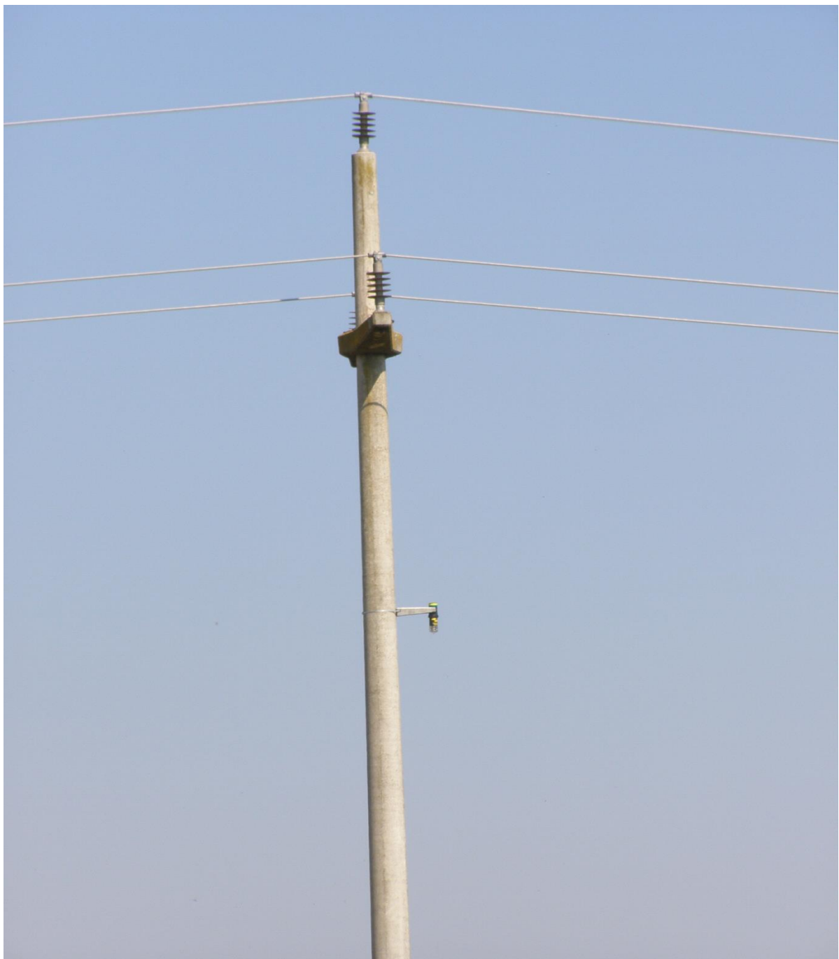
Slika 2.6. LineTroll indikator montiran na stup ispod vodiča [11]
