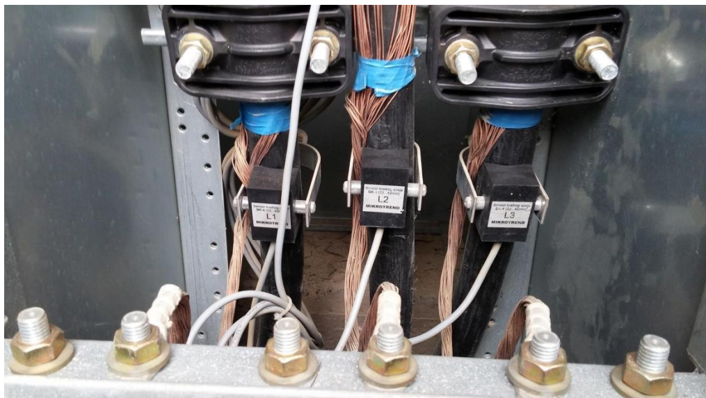
Slika 2.10. Strujni senzori montirani na kabljske završetke u razvodnom ormaru [11]
