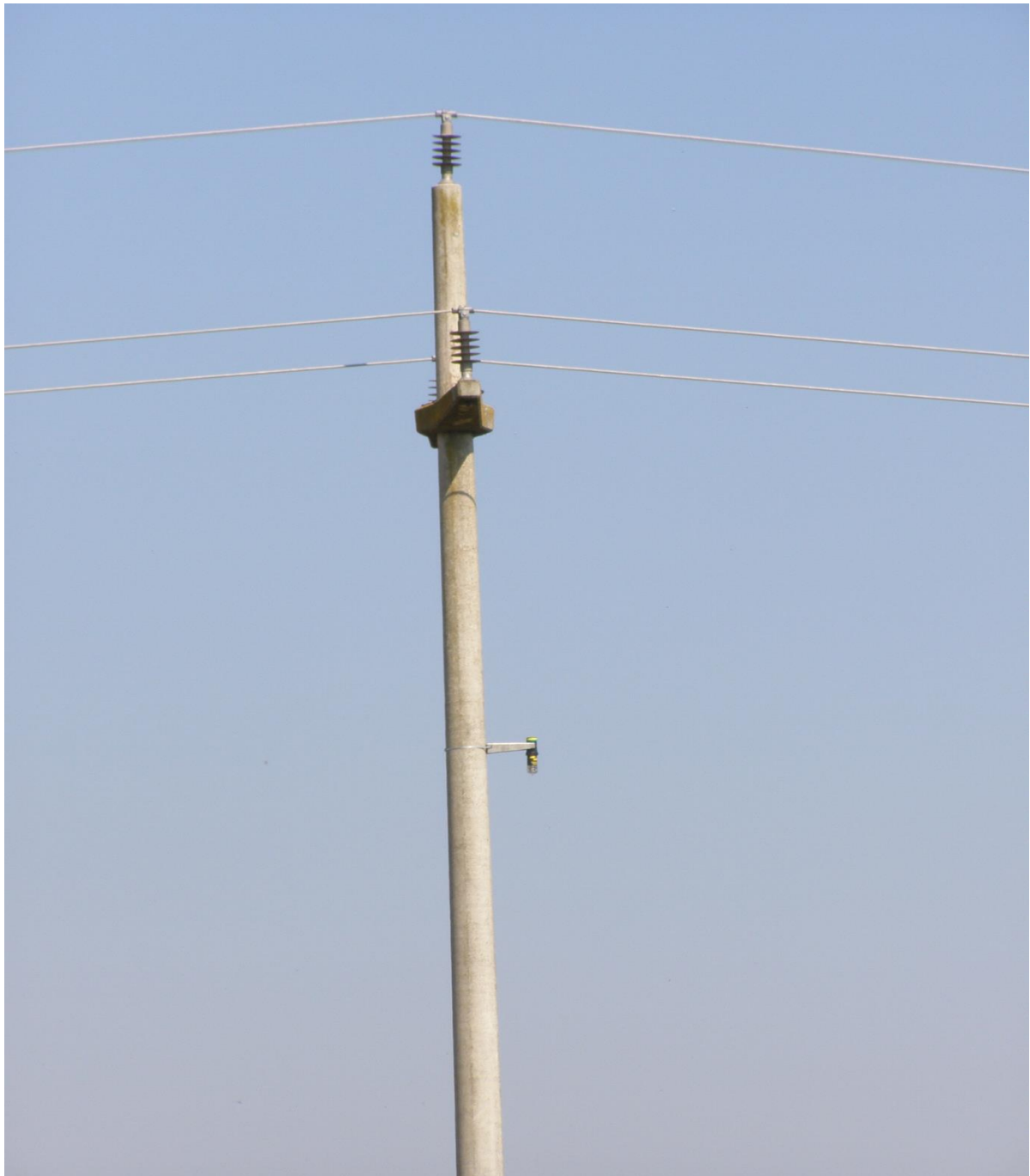
Slika 2.6. LineTroll indikator montiran na stup ispod vodiča [11]
