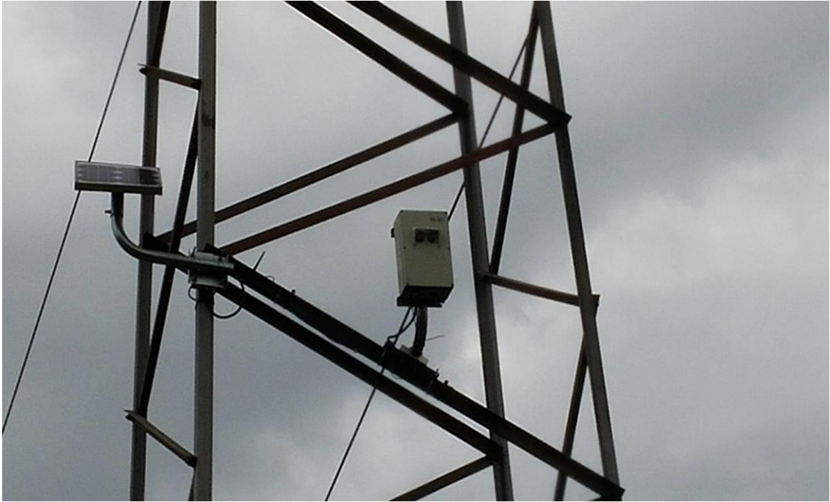
Slika 3.3. Indikator kvara SIK-30 sa solarnim napajanjem
