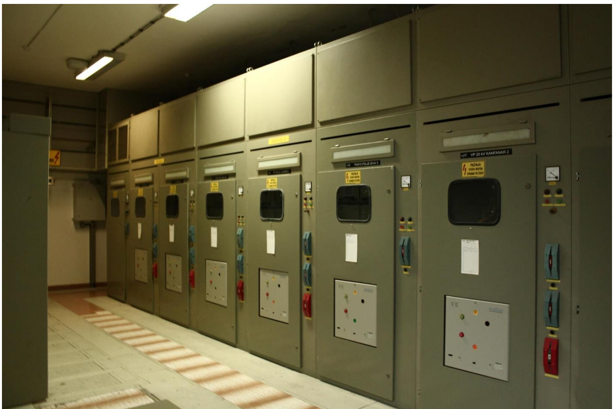
Slika 5.4. Odvojena vodna polja sa prekidačima na 20kV naponu u TS Vinčent
