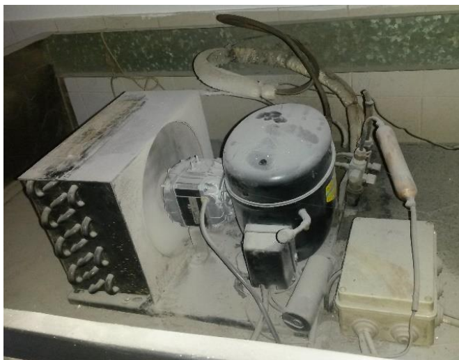
Slika 4.7. Kompresor i ventilator hladnjaka
