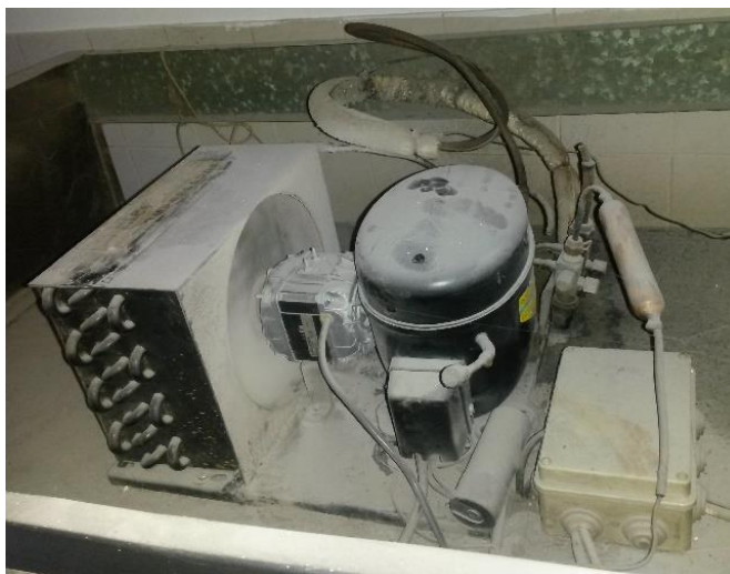
Slika 4.7. Kompresor i ventilator hladnjaka
