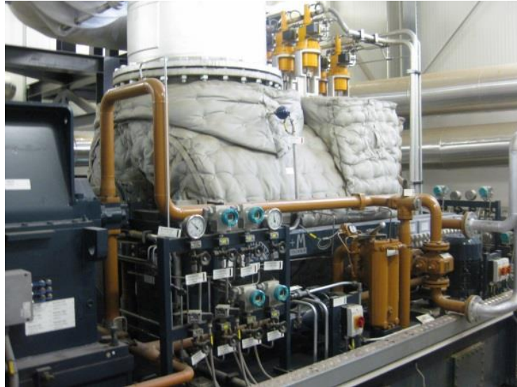
Slika 3.22. Parna turbina u elektrani
