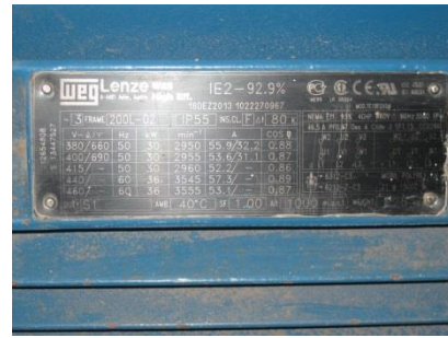
Slika 3.67. Pločica motora BA ventilatora
