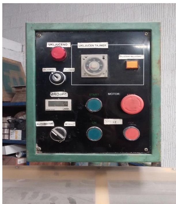
Slika 4.31. Kontrolna kutija zaklopne štanice
