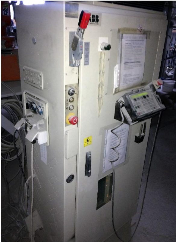
Slika 3.37 Upravljački ormar robota
