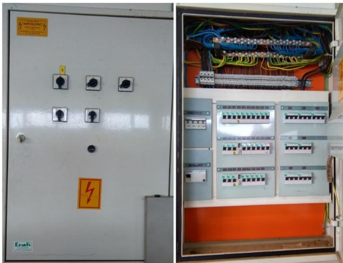
Slika 3.6. Glavni razvodni ormar pogona
