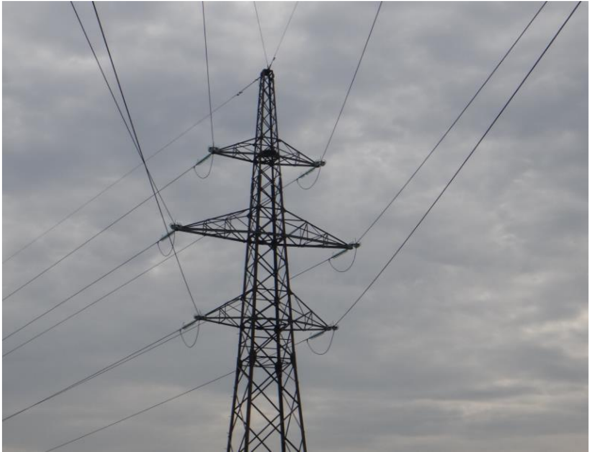
Sl.3.7. Primjer dvostrukog trofaznog 110 kV dalekovoda Županja-Orašje, Tuzla-Orašje
