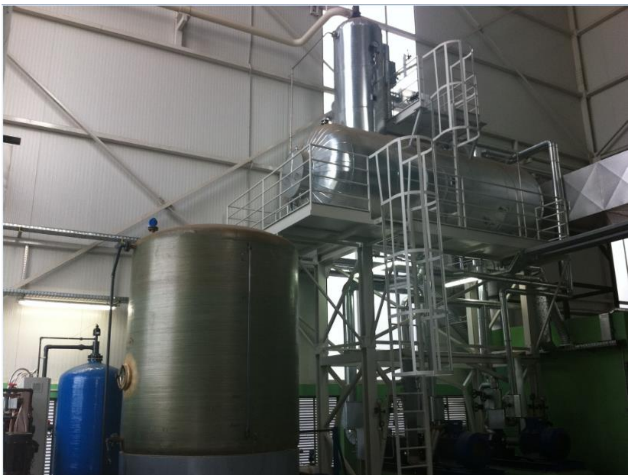
Slika 5.10. Termička priprema vode
