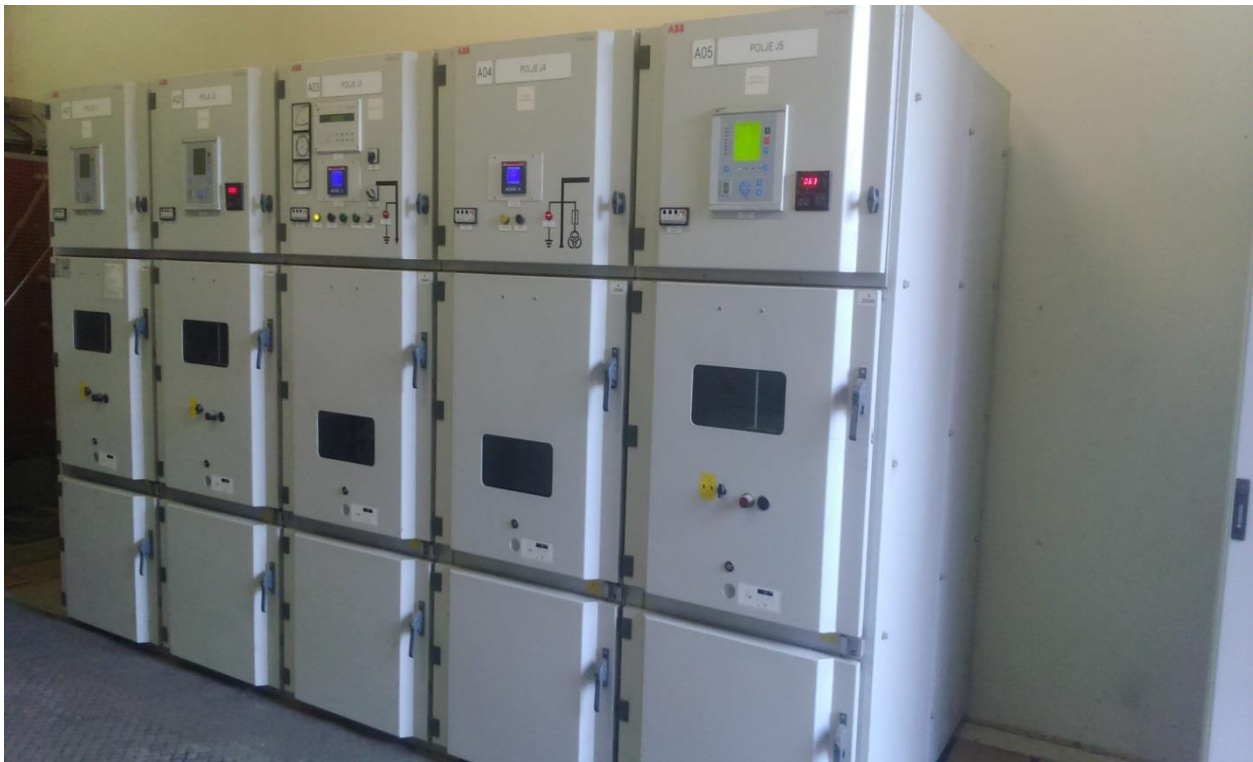
Slika 5.18. Srednje naponsko postrojenje
