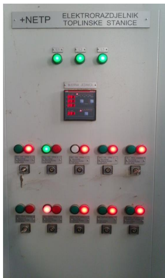
Slika 5.21. Elektrorazdjelnik toplinske stanice
