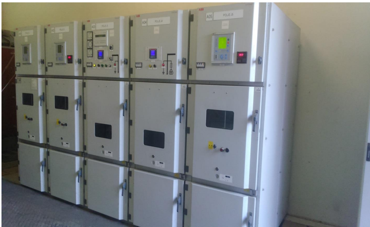
Slika 5.18. Srednje naponsko postrojenje
