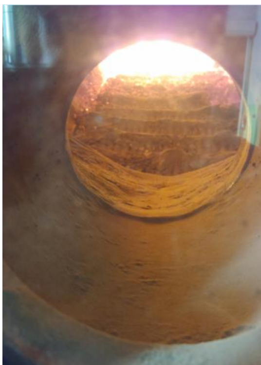
Slika 5.6. Unutrašnji dio kotla
