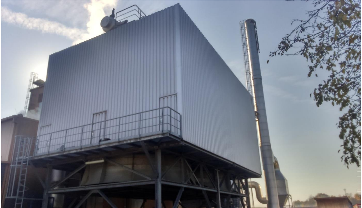
Slika 5.11. Vanjski izgled zračnog kondenzatora
