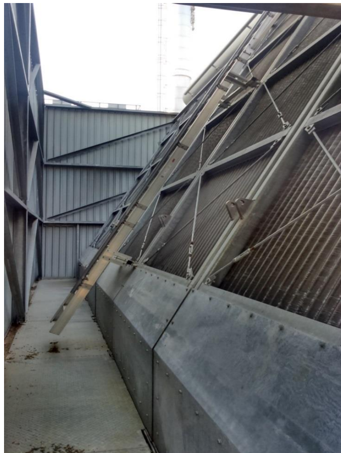
Slika 5.12. Unutrašnji dio kondenzatora
