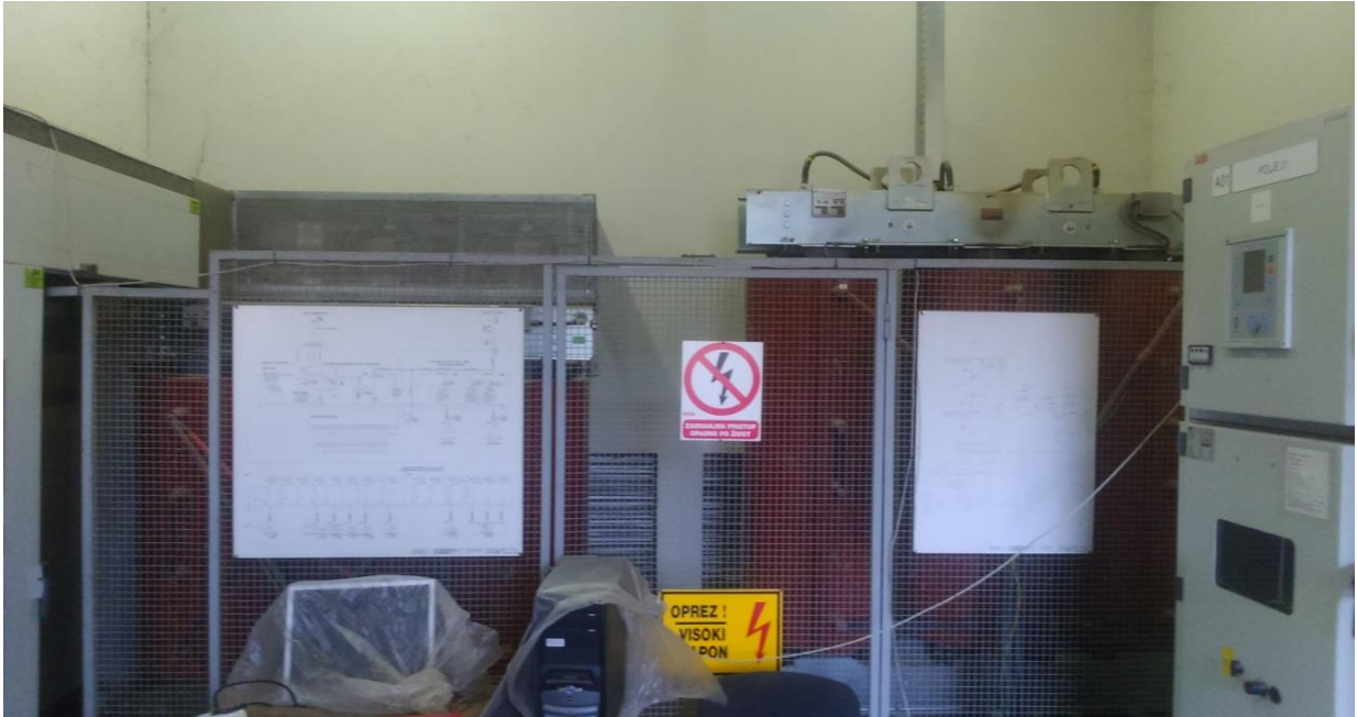
Slika 5.16. Transformator TM i TB
