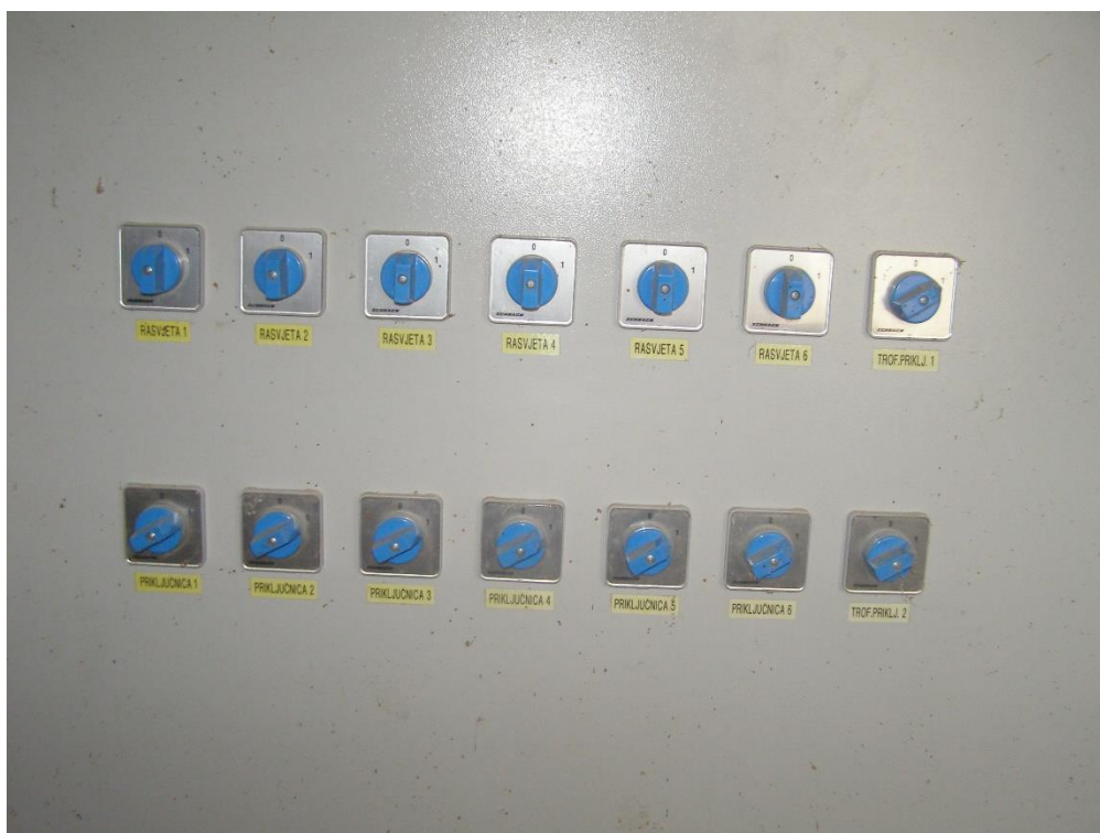
Slika 5.19. Sklopke za rasvjetu
