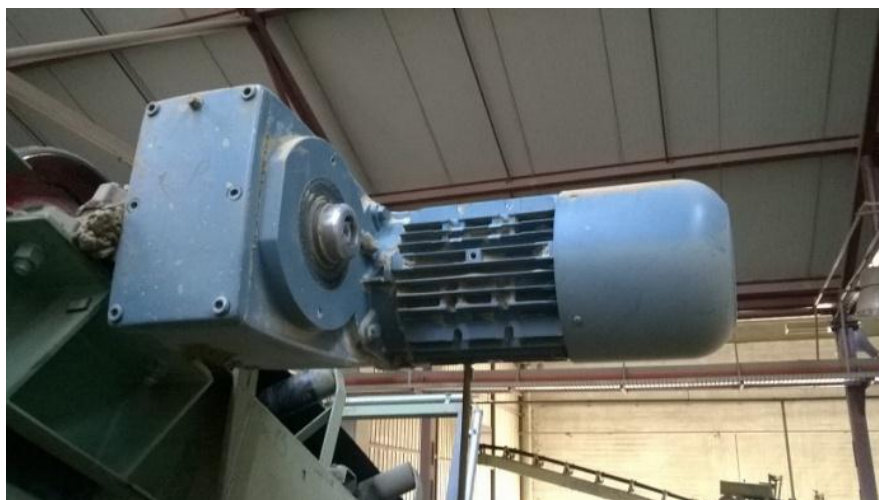
Slika 4.7. Transportna traka i asinkroni motor
