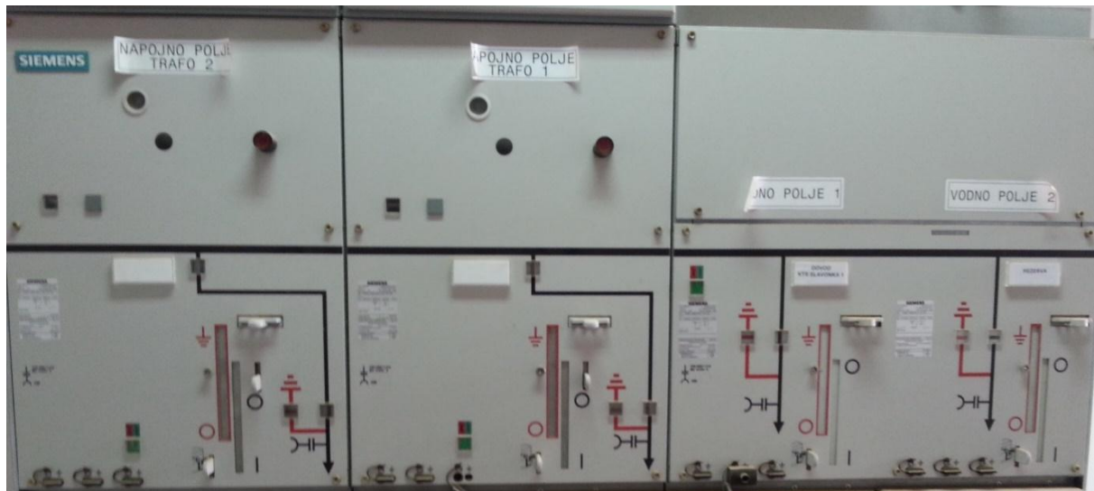
Slika 5.7. Ormar za upravljanje visokim naponom i transformatora
