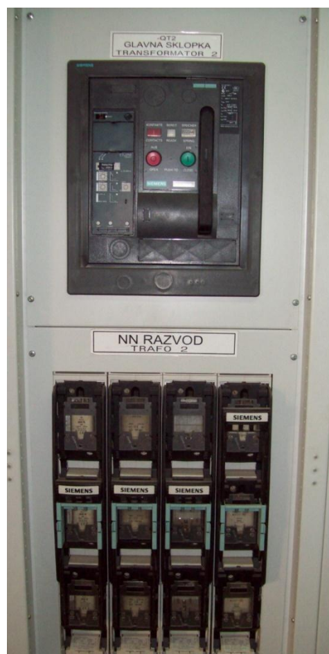
Slika 5.6. Dovodno polje transformator 2
