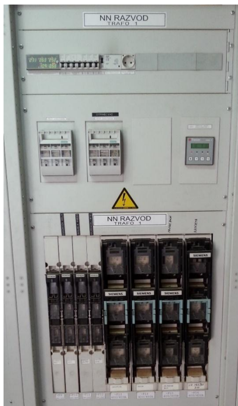
Slika 5.8. Niskonaponski razvod transformator 1
