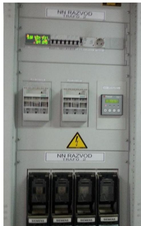
Slika 5.9. Niskonaponski razvod transformator 2
