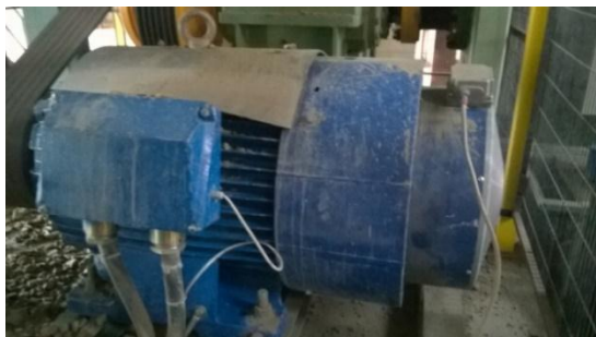
Slika 4.12. asinkroni motor stroja za vakumiranje
